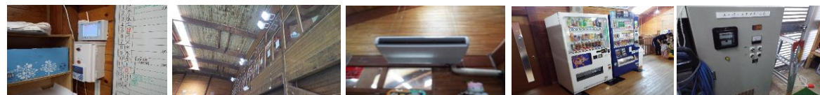
1 デマンドの設置 2. LEDの設置 3. エアコンの更新 4. 自販機の更新 5. ろ過機インバーターの40A→30A
