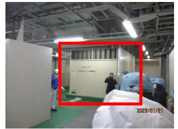
2000 kW GT (防音箱) x 2台
