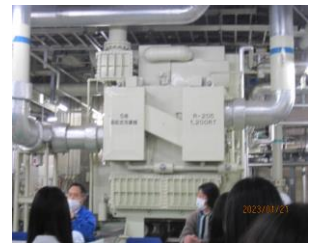
蒸気吸収式冷凍機 (蒸気：GT排熱から製造)
